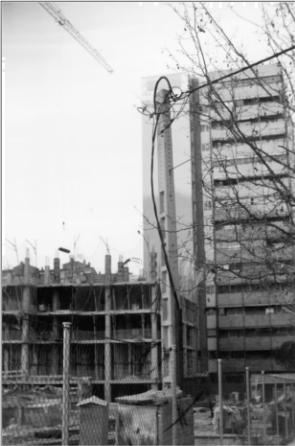
Foto 1.- Suministro a un Edificio en construcción
