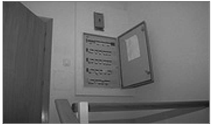
Foto 4. Cuadro General de Protección para una Comunidad de propietarios.
