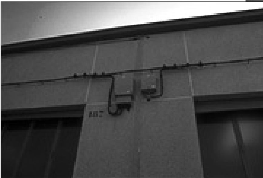
Foto 5. Caja General de Protección tipo intemperie.
